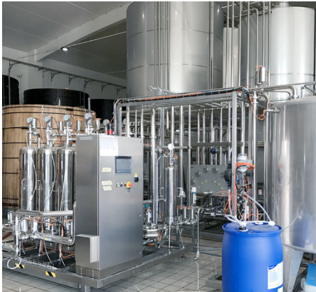
Varvello (Bastiglia, Modena): Système automatisé 2×4 lignes pour la clarification du vinaigre balsamique. 1
